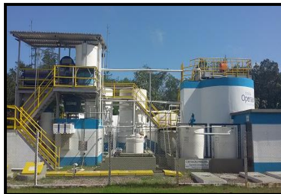
Figura 2: Estação de tratamento de Efluente de onde foi coletado o lodo.
