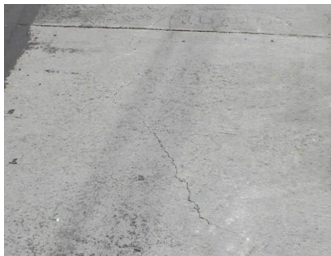
Figura 16: Fissuras superficiais. Fonte: DNIT 061/2004.
