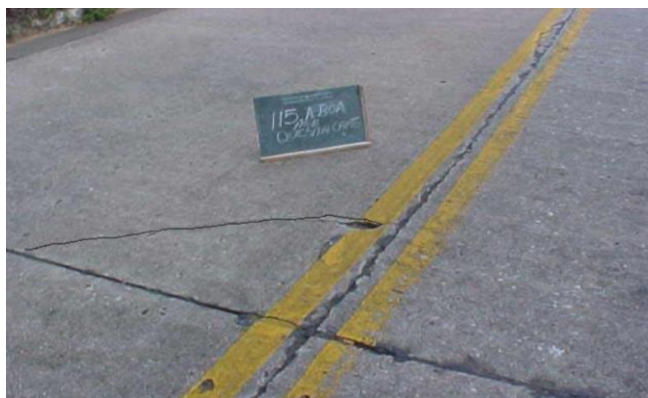
Figura 4: Fissura de Canto. Fonte: DNIT 061/2004.
