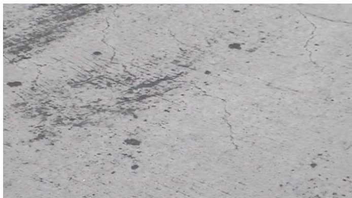
Figura 17: Fissura de retração plástica. Fonte: DNIT 061/2004.
