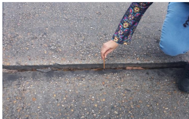
Figura 6: Degrau nas juntas. Fonte: Autores, (2018).
