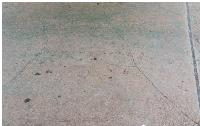
Figura 10: Fissuras diagonais. Fonte: Autores, (2018).
