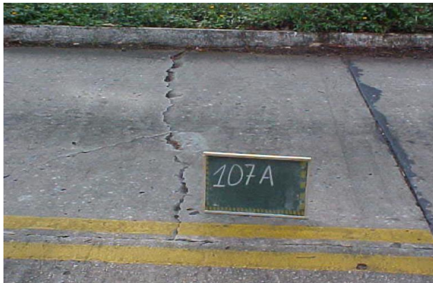
Figura 8: Fissuras transversais. Fonte: DNIT 061/2004.
