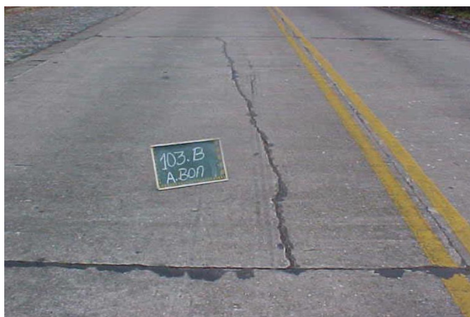
Figura 9: Fissuras longitudinais. Fonte: DNIT 061/2004.
