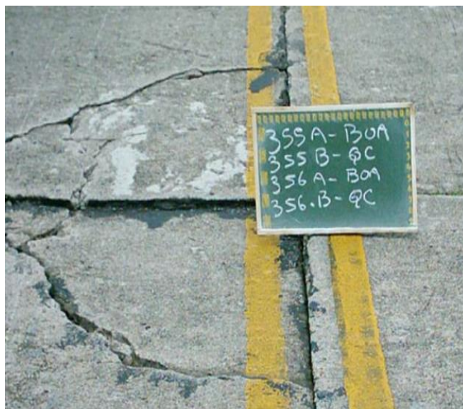
Figura 15: Quebras localizadas. Fonte: DNIT 061/2004. II.13 PASSAGEM DE NÍVEL
