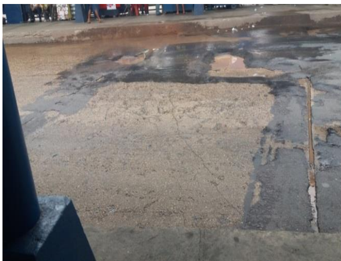
Figura 14: Bombeamento. Fonte: Autores, (2018).
