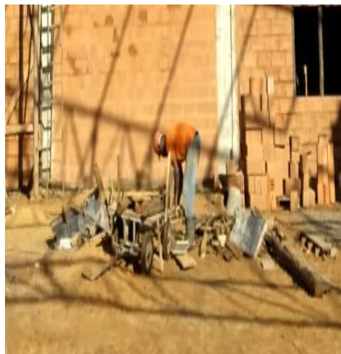
Figura 5: Acúmulo de resíduos na obra. Fonte: Autores, (2018).
