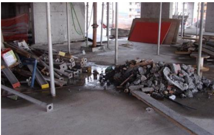
Figura 2: Não conformidade de resíduos. Fonte: CMB Consultoria LTDA, (2018).
