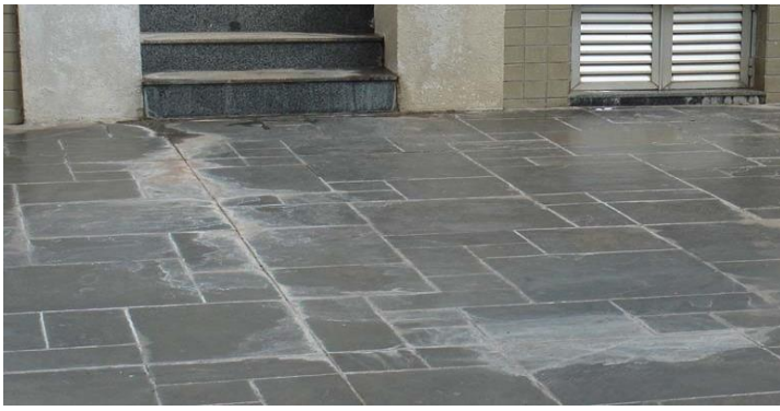
Figura 3: Eflorescência em piso. Fonte: [20].
