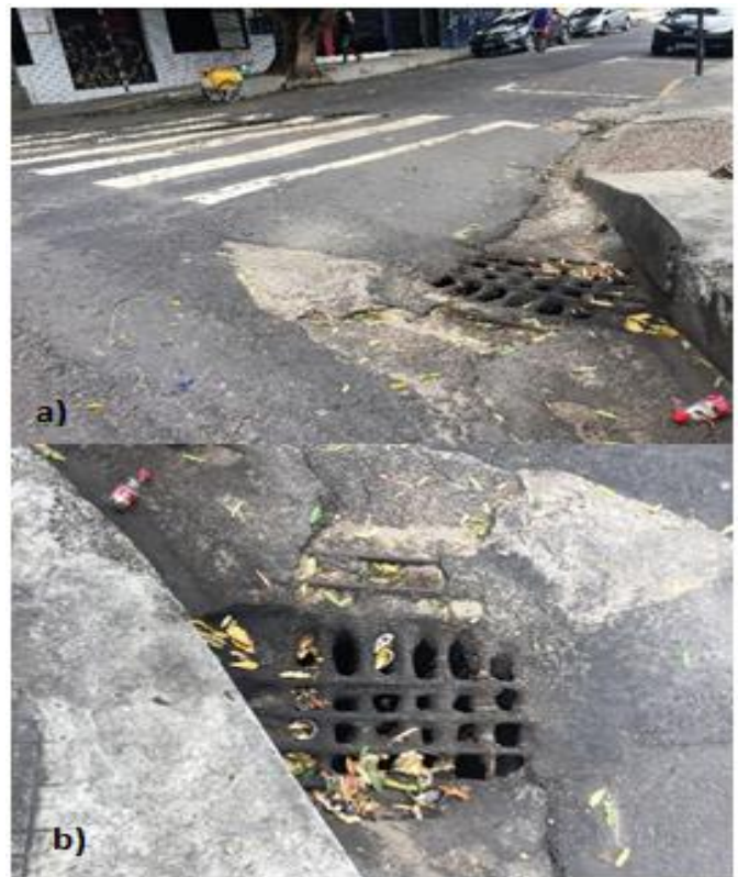
Figura 7. Boca de lobo II. Fonte: Autores, (2018).
