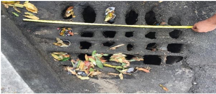
Figura 3: Boca de lobo II, esquina Avenida Getúlio Vargas/Rua Huascar Figueiredo. Fonte: Autores, (2018).
