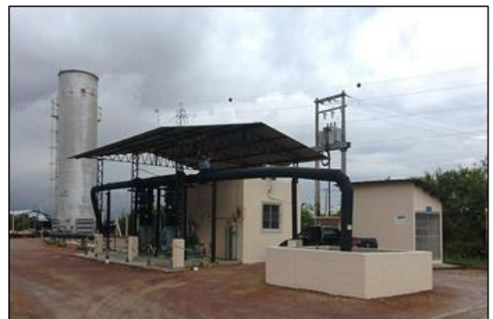
Figura 2: Planta de Captação e Queima de Biogás do Aterro de Manaus.
