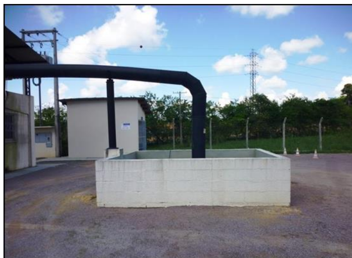
Figura 6: Caixa de remoção de condensado. Fonte: Autor, (2018).
