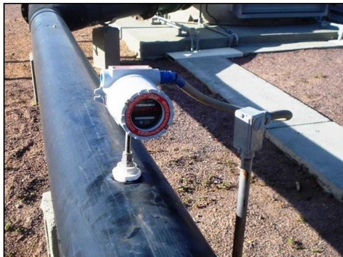
Figura 9: Medidor de Vazão de LFG. Fonte: Autor, (2018).
