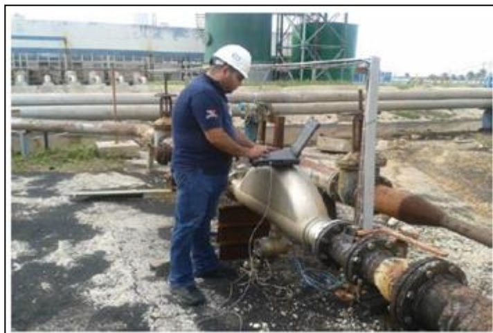
Figura 10: Flujómetro Coriolis instalado para la transferencia fiscal.
