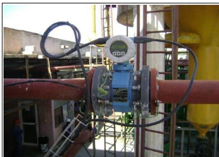
Figura 12: Flujómetro Promag 10P2F a la entrada de los tanques de agua cruda.
