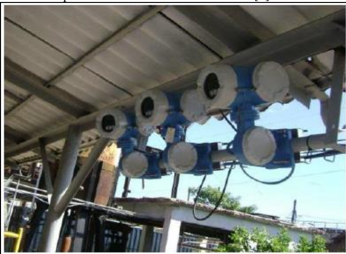
Figura 2: TankSide Monitor NRF590, instalados en el campo. Fuente: Los Autores, (2015).
