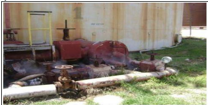
Figura 7: Calentador de Boca de uno de los tanques de almacenamiento de combustible.
