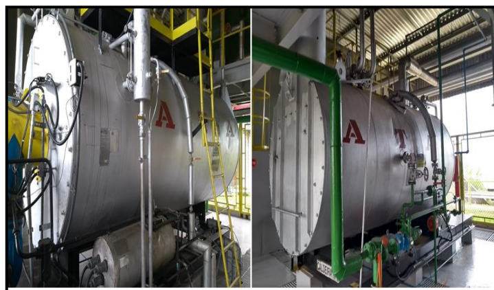
Figura 5: Vista geral da caldeira nº2. Fonte: Autores, (2019).
