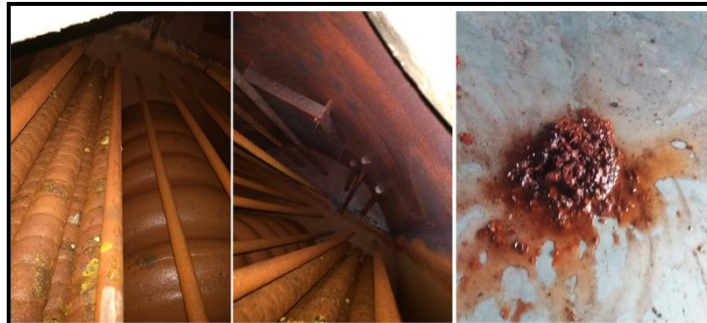
Figura 14: Exame interno e amostra de ferrugem retirada.
