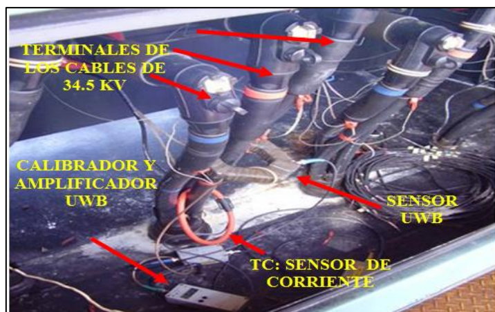
Figura 6: Medición de descargas parciales en línea en las terminales del cable submarino.
