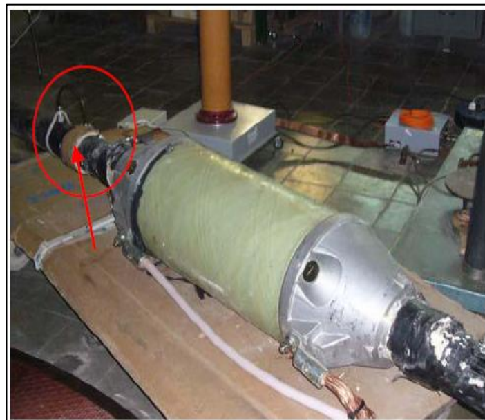
Figura 7: Sensor ubicado próximo a un terminal de AT.
