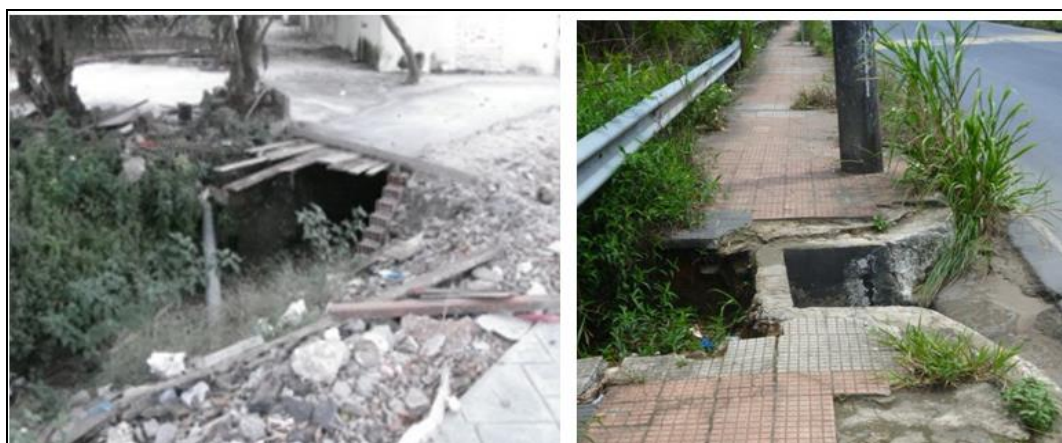
Figura 5: Imagem mostrando o estado de degradação e falta de saneamento básico do Calçadão. Fonte: Autores, (2017).
