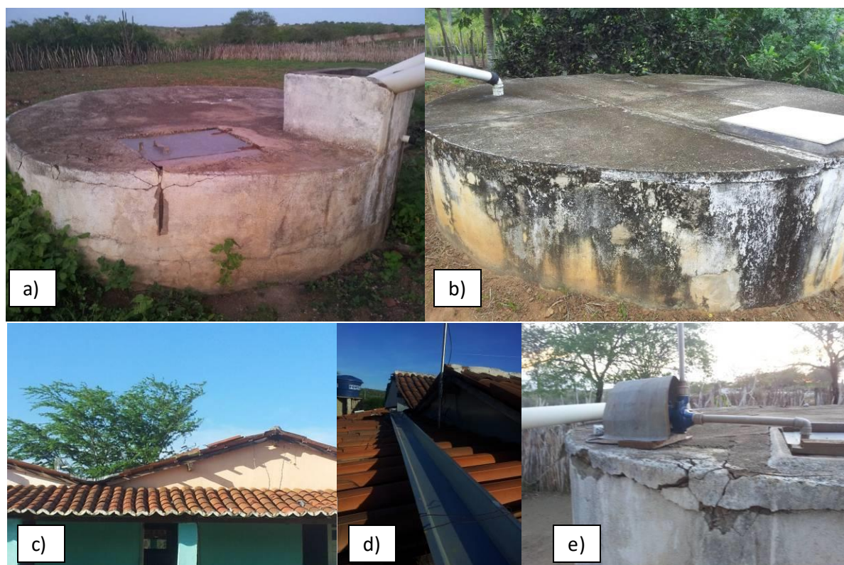
Figura 1: a) Estado geral da cisterna do Sistema 15 (Ruim), em Cabaceiras – PB; b) Estado da pintura da cisterna do Sistema 27 (Ruim), em São Sebastião de Lagoa de Roça – PB; c) Estado geral do telhado do Sistema 12 (Ótimo), em Cabaceiras – PB; d) Calha do Sistema 12 (Bom), em Cabaceiras – PB; e) Cisterna na qual se utiliza bomba elétrica, em Cabaceiras – PB.
