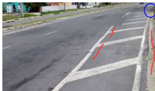
Figura 31: Afundamento e Escorregamento de Revestimento Betuminoso. Fonte: Autores, (2017).
