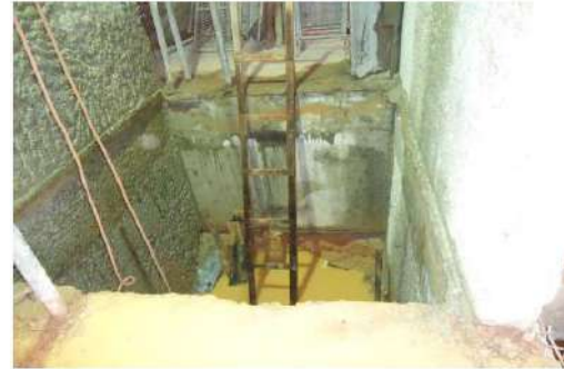
Figura 4: Pilares escarificados no segundo subsolo da torre 03. Fonte: Autores, (2019).
