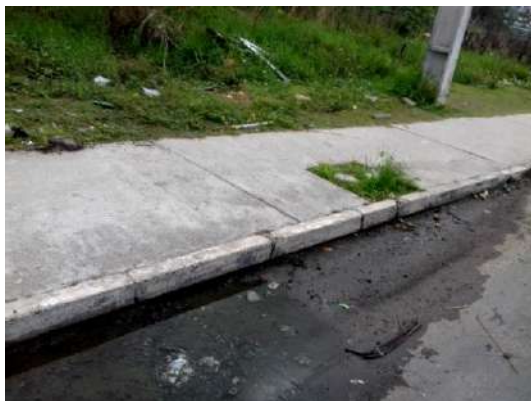
Figura 29: Possível ausência de dispositivo hidráulico. Fonte: Autores, (2017).
