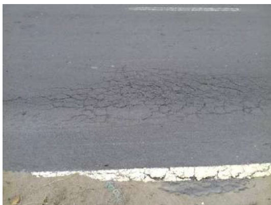
Figura 30: Trincas do tipo Couro de Jacaré. Fonte: Autores, (2017).
