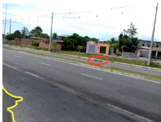
Figura 28: Acúmulo de água na via (09/2015).
