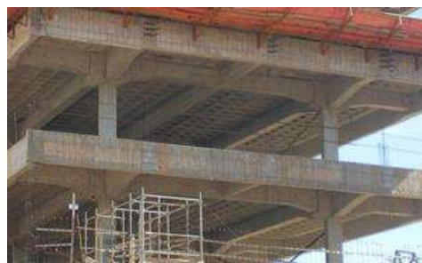
Figura 5 - Viga Convencional. Fonte: [11].
