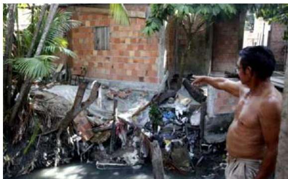
Figura 9: Risco de desabamento por erosão. Fonte: Autores, (2017).
